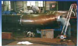
■電力大型配管
