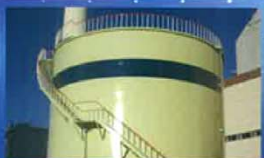
■発電所用タンク
