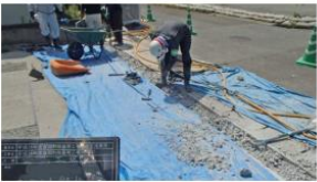
舗装のひび割れ
