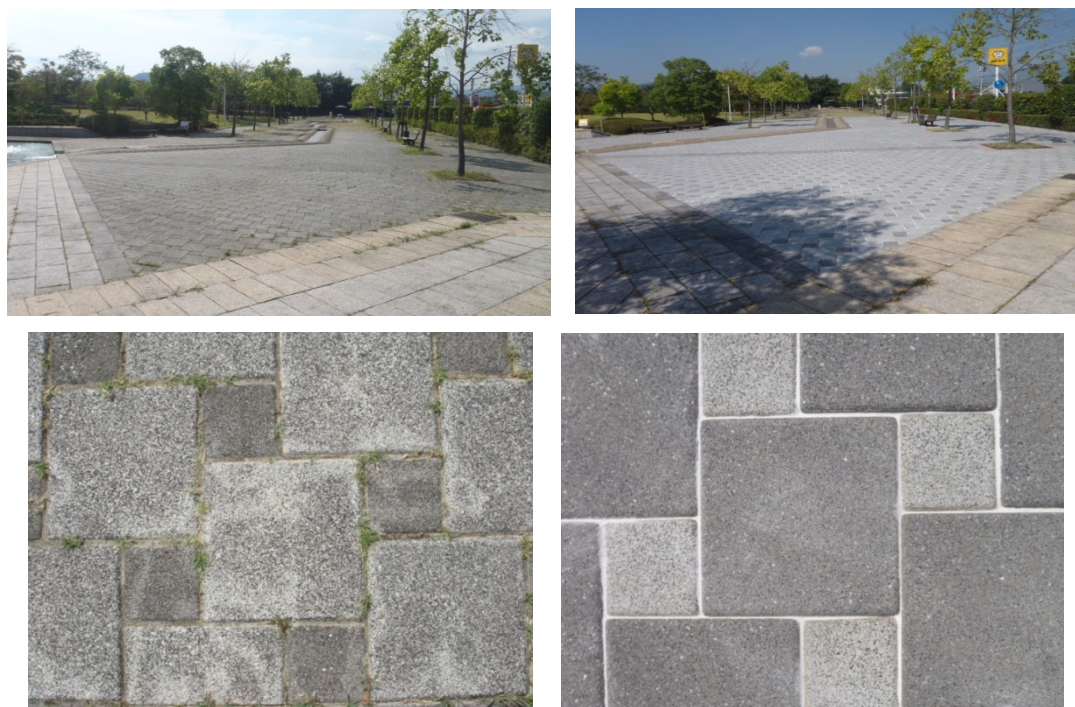
図3 除染前後の全景（上段）と表面状態（下段）。左列は除染前、右列は除染後。除染により目地砂は回収されてしまうため、除染後白い目地砂を入れている。
