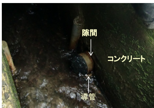
②導管とコンクリートとの間の隙間から漏水
