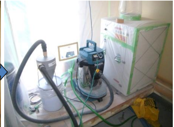
機器配置 左：サイクロン 中：集塵機 右：除塵機
