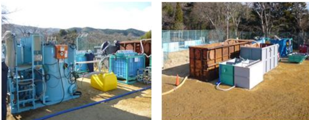
図 2.4.2(2)-11 洗浄水等の処理施設概要（浪江町）
