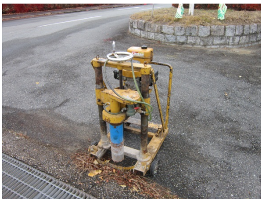
a) コアドリルを用いてアスファルト舗装の供試体を採取
