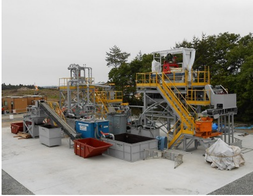
図2 土壌除染用実証プラント
